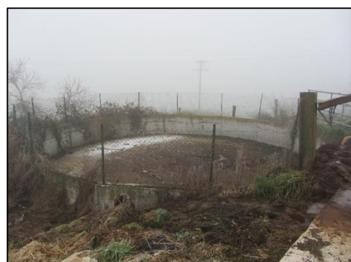
Fosse béton circulaire sur le site de Calmels
